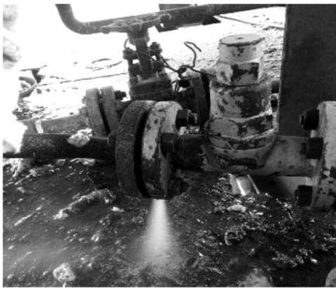
图2 管道蒸汽泄露
